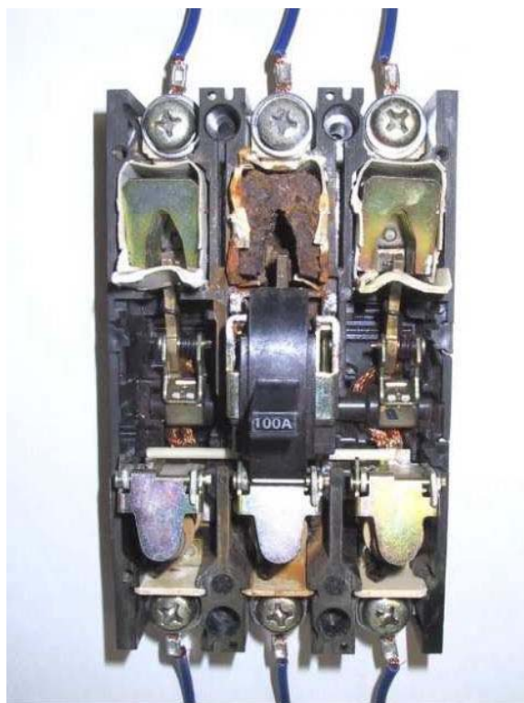
図 2-2 中性線が発錆した状態
