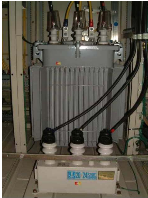
図 1-3 受電設備に設置される変圧器と進相コンデンサ
