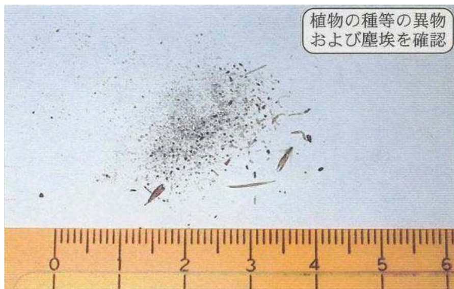
図 2-1 接触不良開閉器の内部にあった塵埃
