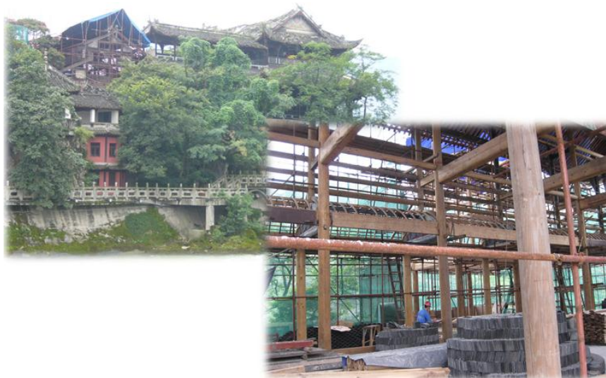
図 4-3 修復中の文化財建造物—都江堰観光地の伏龍觀 (2009 年 8 月 28 日 現地調査より)
