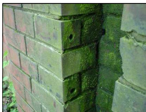
写真-6.3.2 N 構面破損部の観察
