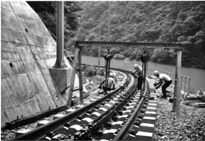
写真6 井川線のラック式鉄道の橋梁(市代橋梁)は道床付で施工 2) (1989年秋・写真撮影：白井昭)
