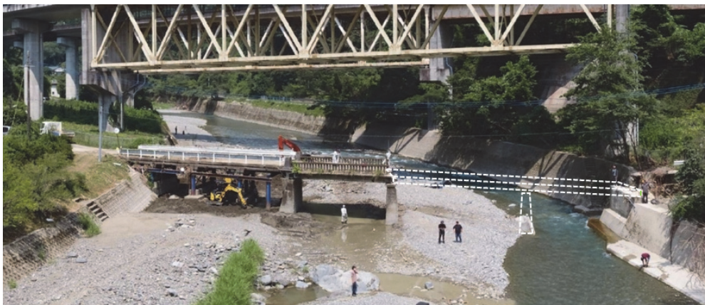
写真-1.4 2020年7月豪雨にて河川の氾濫により桁と橋脚が流失した事例
