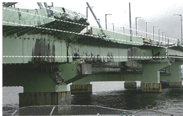
写真-1.3 2018年台風21号にてタンカー船衝突により損傷を受けた事例 6) に加筆
