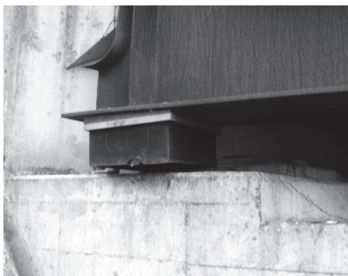
写真-2.1 支承下部に損傷が生じた事例 (2016年熊本地震)
