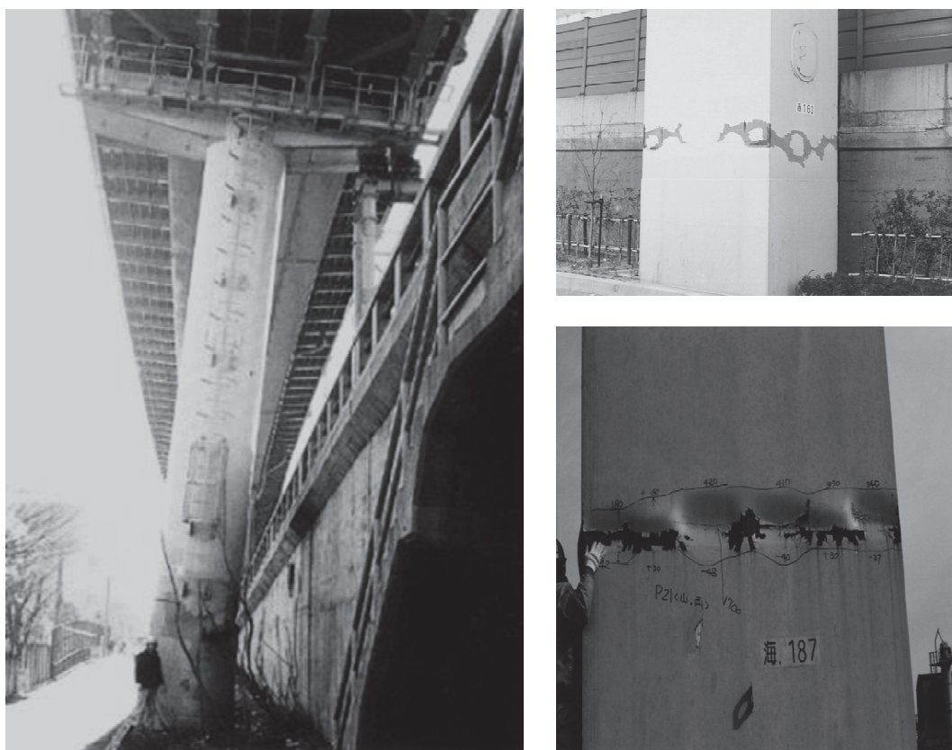
(a) 橋脚の損傷
