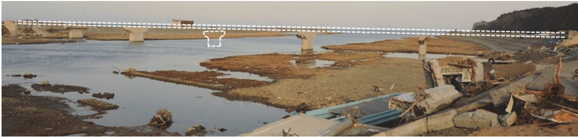
写真-1.1 2011年東日本大震災にて津波により桁と橋脚が流失した事例 2) に加筆
