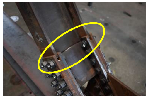
(d) ブレース材(D)の破断
