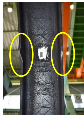
(b) ブレース材(B)下面の局部座屈
